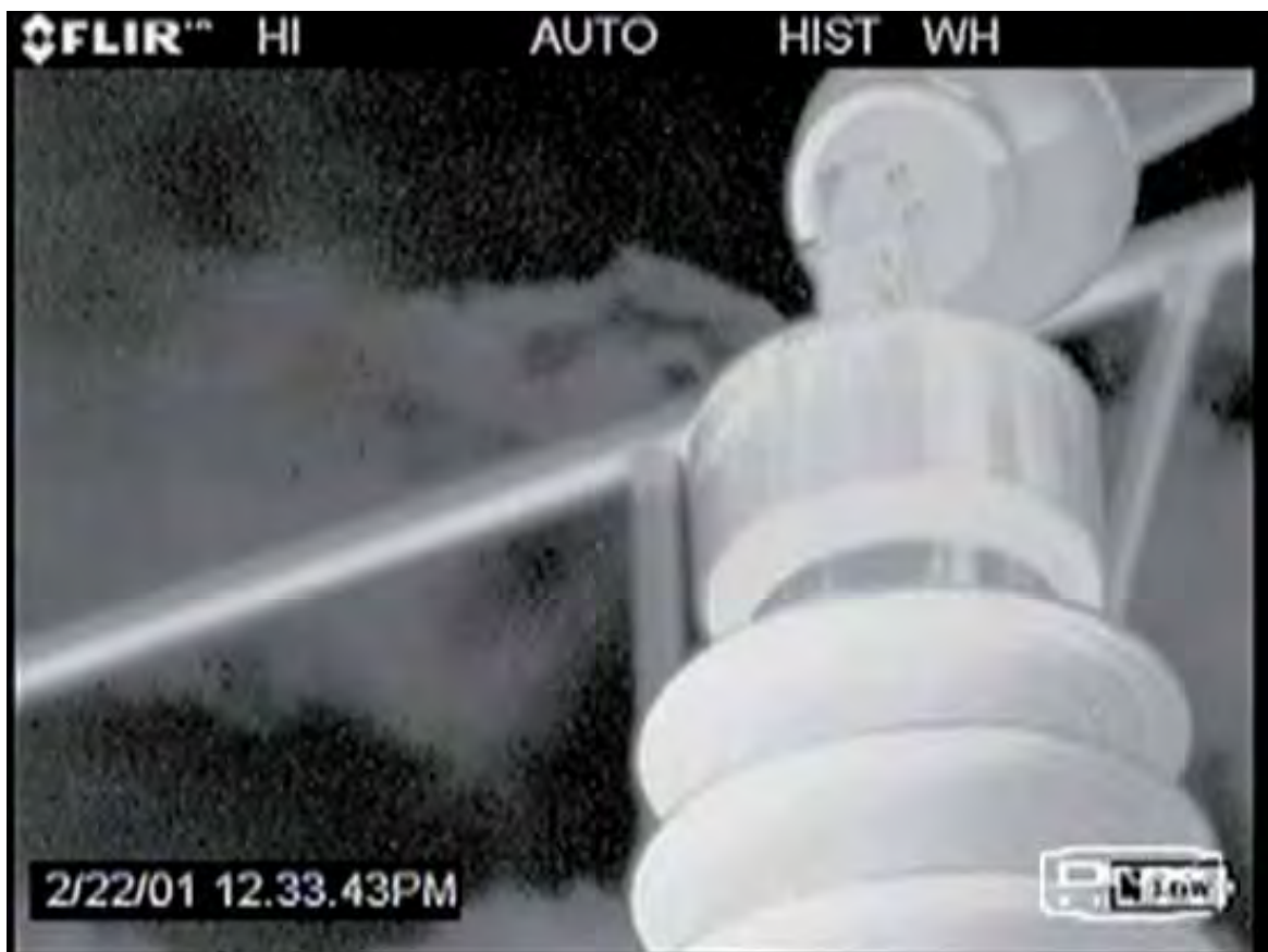
高圧断熱材からのSF 6 (六フッ化硫黄)漏れ
