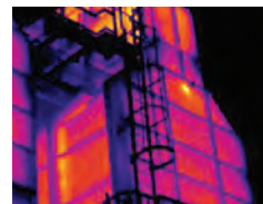
石油精錬所におけるガス漏れ
